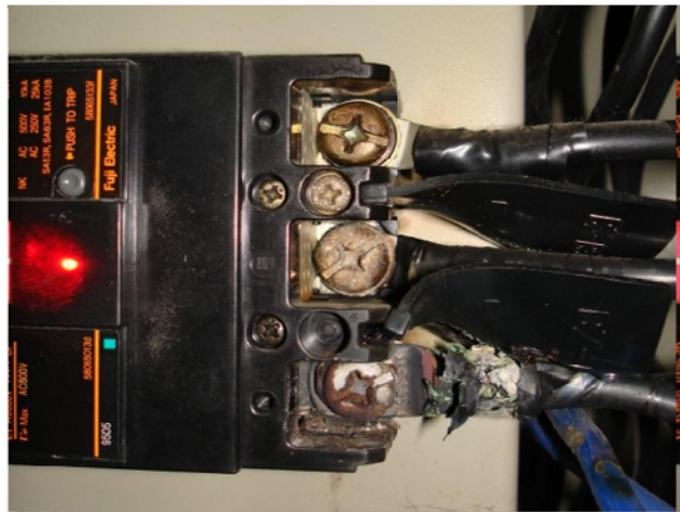
รูปที่ 5 ตัวอย่างข้อต่อสายเข้าเซอร์กิตเบรกเกอร์ชำรุด เนื่องจากหลวม
