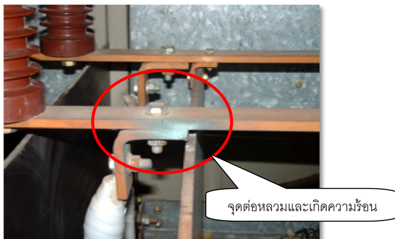
รูปที่ 12 ตัวอย่างจุดต่อบัสบาร์ที่หลวมและเกิดความร้อน
