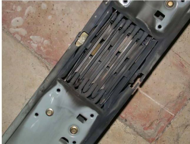
รูปที่ 4 บัสเวย์ชำรุดจากรจุดต่อหลวมจนเกิดความร้อนสูง (ใช้ทอร์กไม่เหมาะสม)
